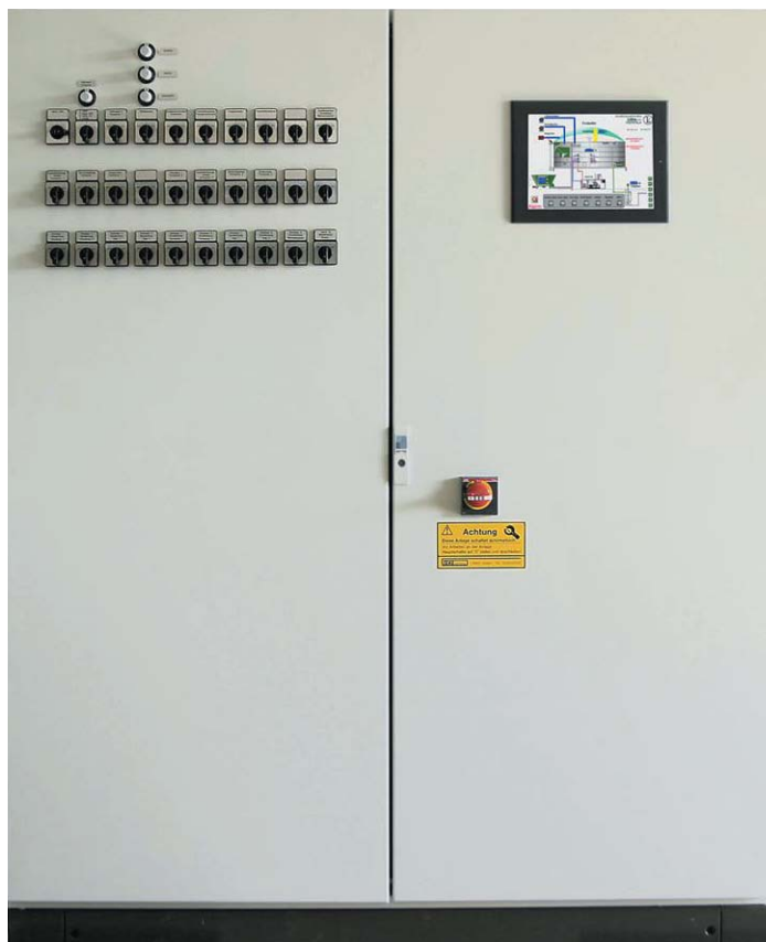
Inima și creierul instalației de biogaz: Unitatea de comandă centrală, cu display
