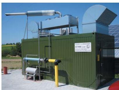
Zbudowany , w sposób kompaktowy, kontener z izolacją dźwiękową. – silnik gazowy, turbina, wymienniki ciepła.
