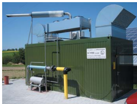
Kompakt, Schallgeschützt und schnell errichtet: Das Container-BHKW
