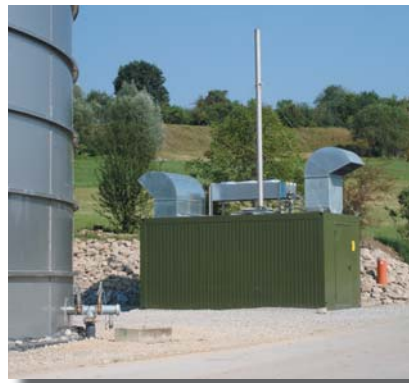
Blockheizkraftwerk in Containerbauweise
