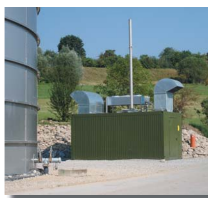
Kogenerační jednotka kontejnerové konstrukce
